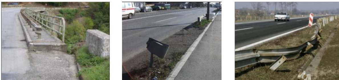
Slika 1. Primeri lošeg postavljanja i održavanja zaštitne ograde
